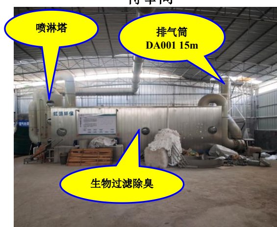
废气处理装置
