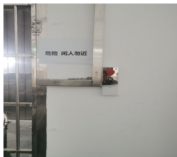
现场急停装置 2
