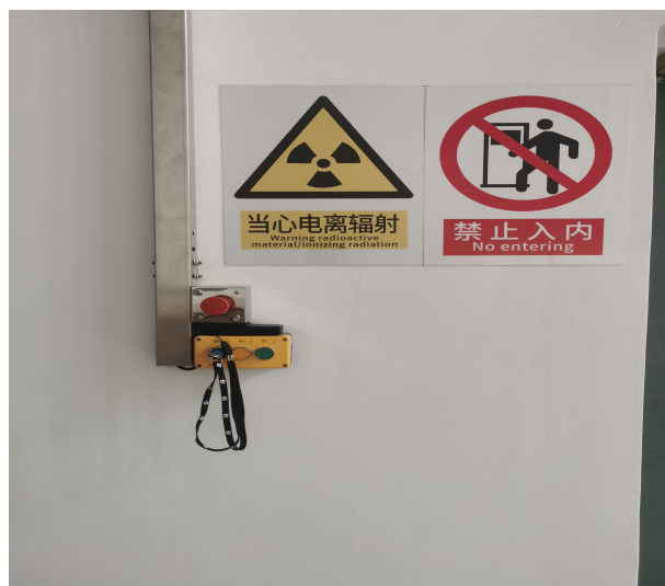
主机室入口紧急开门装置
