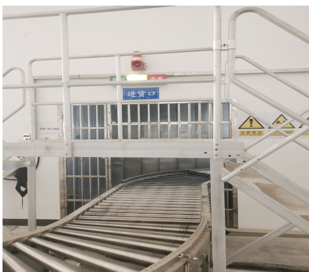
辐照室入口报警装置
