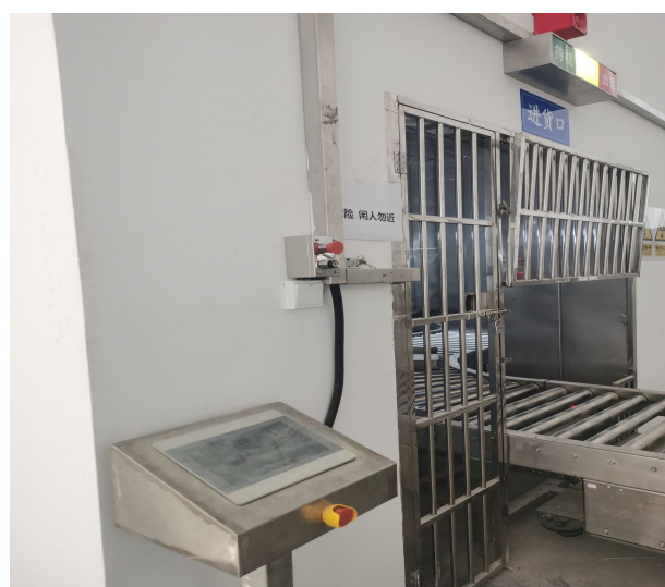
现场急停装置 1
